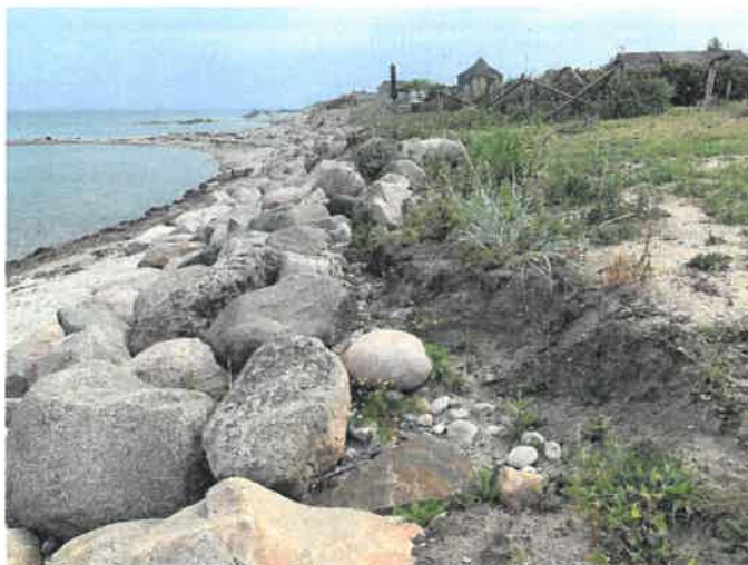
Figur 2.4: Skråningsbeskyttelsen har for smal kronebredde, hvilket muliggør erosionskår landværts kronen.
