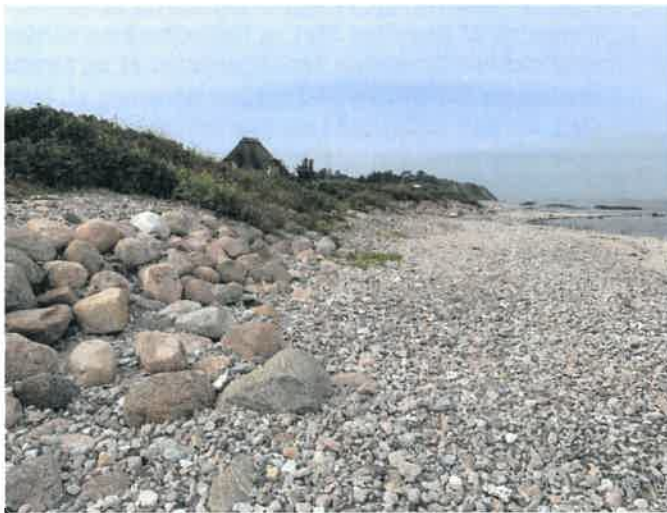
Figur 2.10: I den nordøstlige del af delstrækning B har bevoksningen arbejdet sig ind i den mest landværts del af skråningsbeskyttelsen. Den naturlige strandbred indeholder store mængder ral i tomboloen bag bølgebryderen ved Spodsbjergstien 11.
